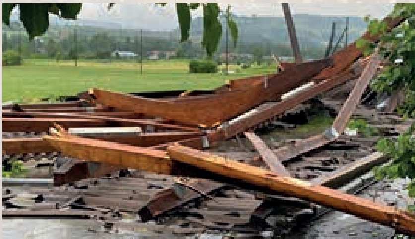
Die Driving Range beim Golfplatz Kiesen wurde am Sonntagnachmittag durch den Sturm total zerlegt.
